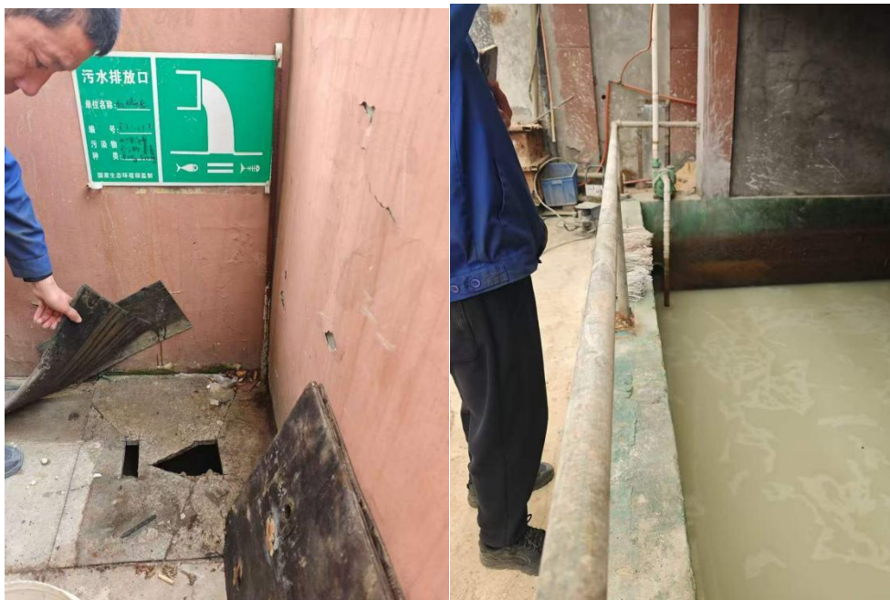
图 3-1 废水处理设施及排放口照片
