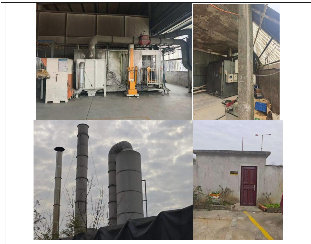
图 3-2 废气处理措施
