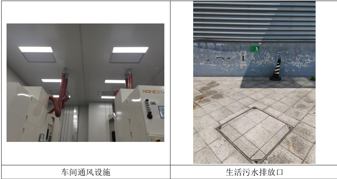
图 3.5-4 车间废气处理、生活污水排放口现场照片
